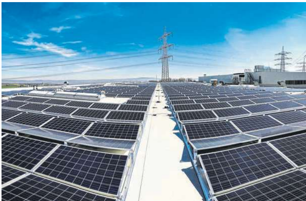
Solarenergie ist gefragt wie nie. Auch auf den Dächern der Rhein-Zeitung hat Wi Solar eine Fotovoltaikanlage auf einer Fläche von 8900 Quadratmetern und mit einer Leistung von knapp 650 000 Kilowattstunden pro Jahr installiert. Wi Solar ist darauf spezialisiert, seinen Kunden bei der Errichtung von Fotovoltaikanlagen ein Gesamtpaket zu bieten.
