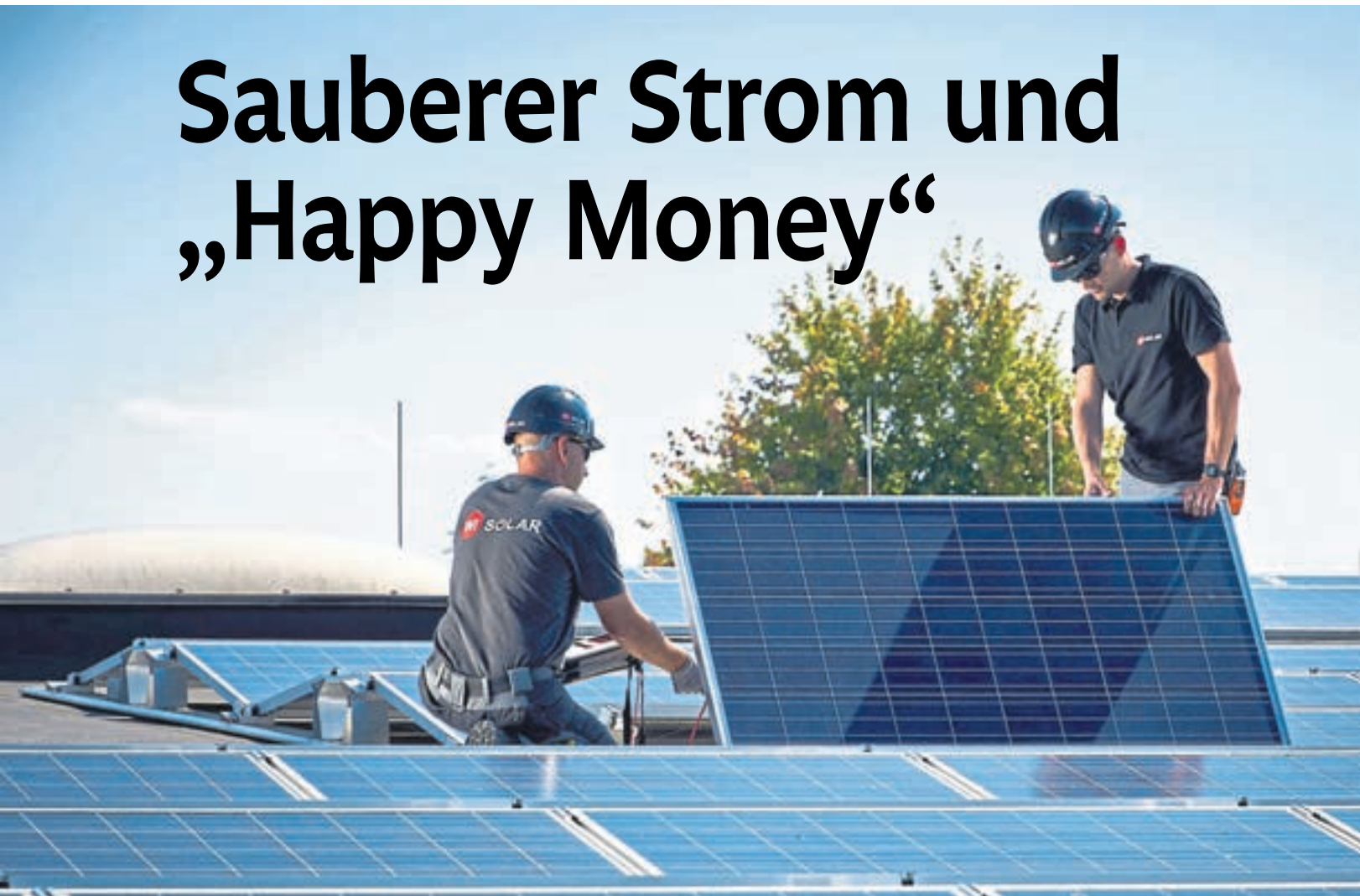
Sonnenenergie lässt sich sehr gut in neue und bestehende Bauten integrieren, unabhängig vom Standort. Auf diesem Bild wird eine Fotovoltaikanlage in einem Gewerbegebäude installiert.
